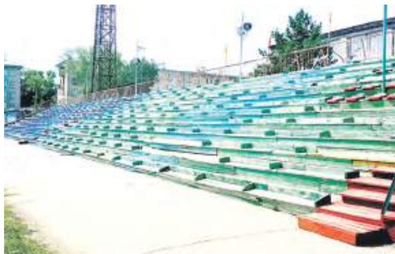
Трибуны стадиона требуют ремонта.
