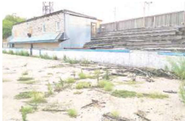
Хоккейная коробка на СК «Торпедо» давно нуждалась в ремонте.
