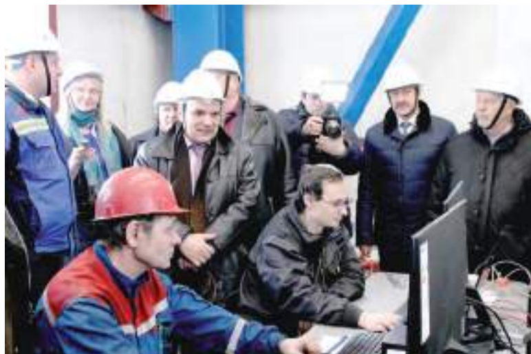
Сердце станции – щит управления.
