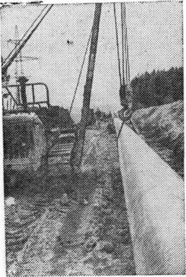
Закарпатская область. Через реки, горы и долины к границе Чехословакии и Венгрии идет карпатским краем трасса нефтепровода «Дружба». Самоотверженно работают строители.
