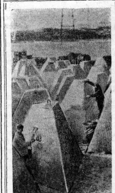
Строители Сталинградской ГЭС готовятся к перекрытию Волги. Здесь изготовляются 10-тонные бетонные пирамиды, которые будут сбрасываться на дно реки для создания перемычки. На снимке: маркировка и обмер изготовленных бетонных пирамид. Фото А. Маклецова. Фотохроника ТАСС.
